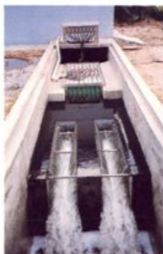
厦门市政污水 紫外消毒系统。
