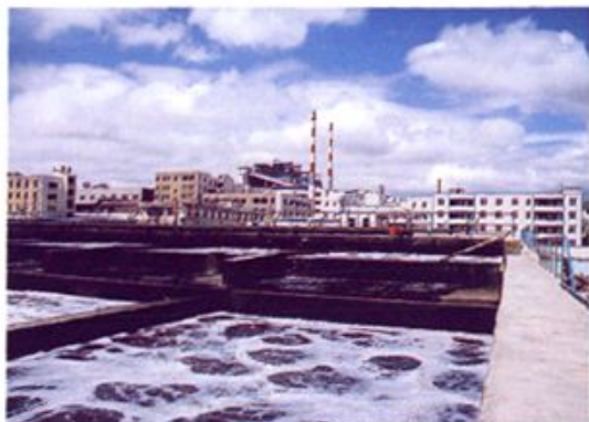
石狮大堡集控区污水处理中心。
