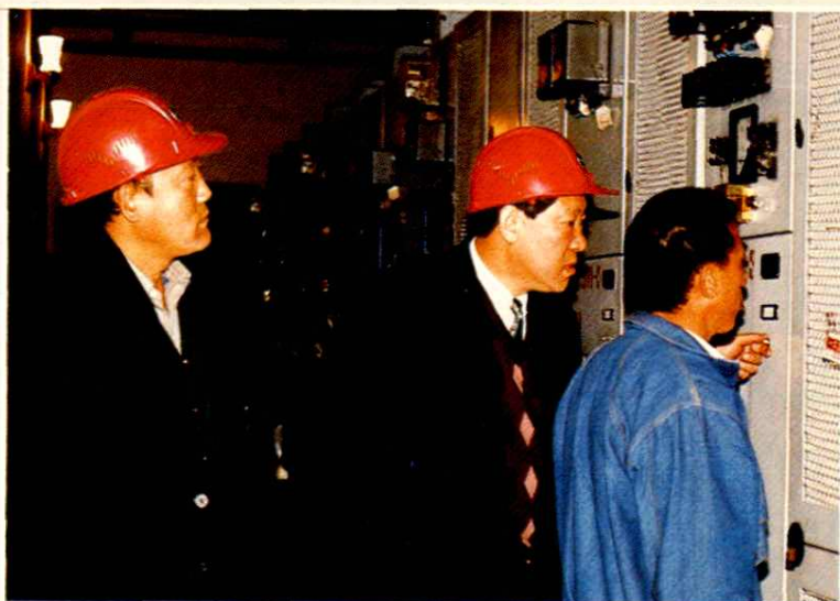
临汾地区电业局局长卫克俭（中）在 隰县变电站检查工作
