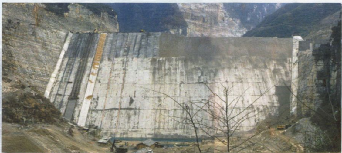
湖北西北口水电站大坝面板采用基础局发明的无轨滑模技术进行面板施工
