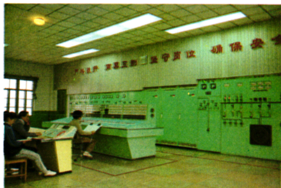
220 千伏邵武故县变电站主控室
