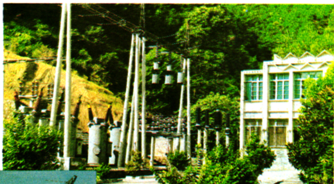
220 千伏南平马站变电站
