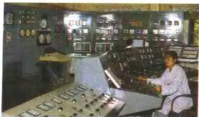
凤凰山 铜矿自 动控制 室
