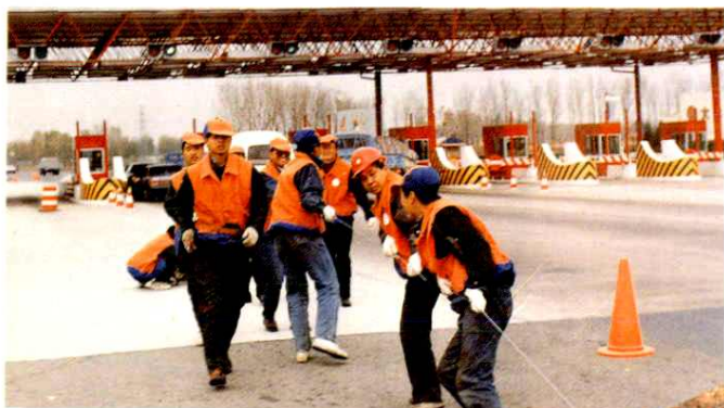
高速公路通信工程
