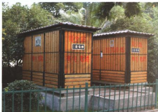
杭州市区凤起路上的配网开关站
