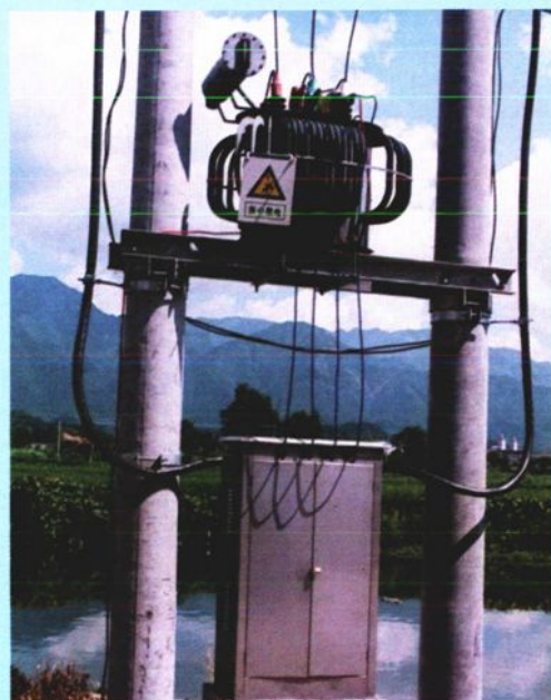
2000年3月， 经过大规模的农村 电网改造与农村 用电管理整顿， 变压器设备 面貌一新
