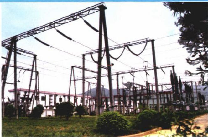
220 千伏杭钢用户变电所
