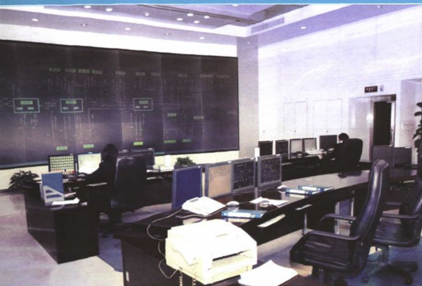
杭州市电力局调度所市区配电网 调度大屏幕投影显示系统
