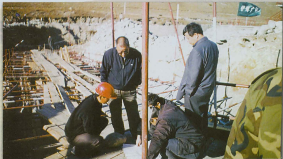
州水利局总工程师王春新与夏塔灌区改造配套工程渠首改建技术人员共同研究图纸。
