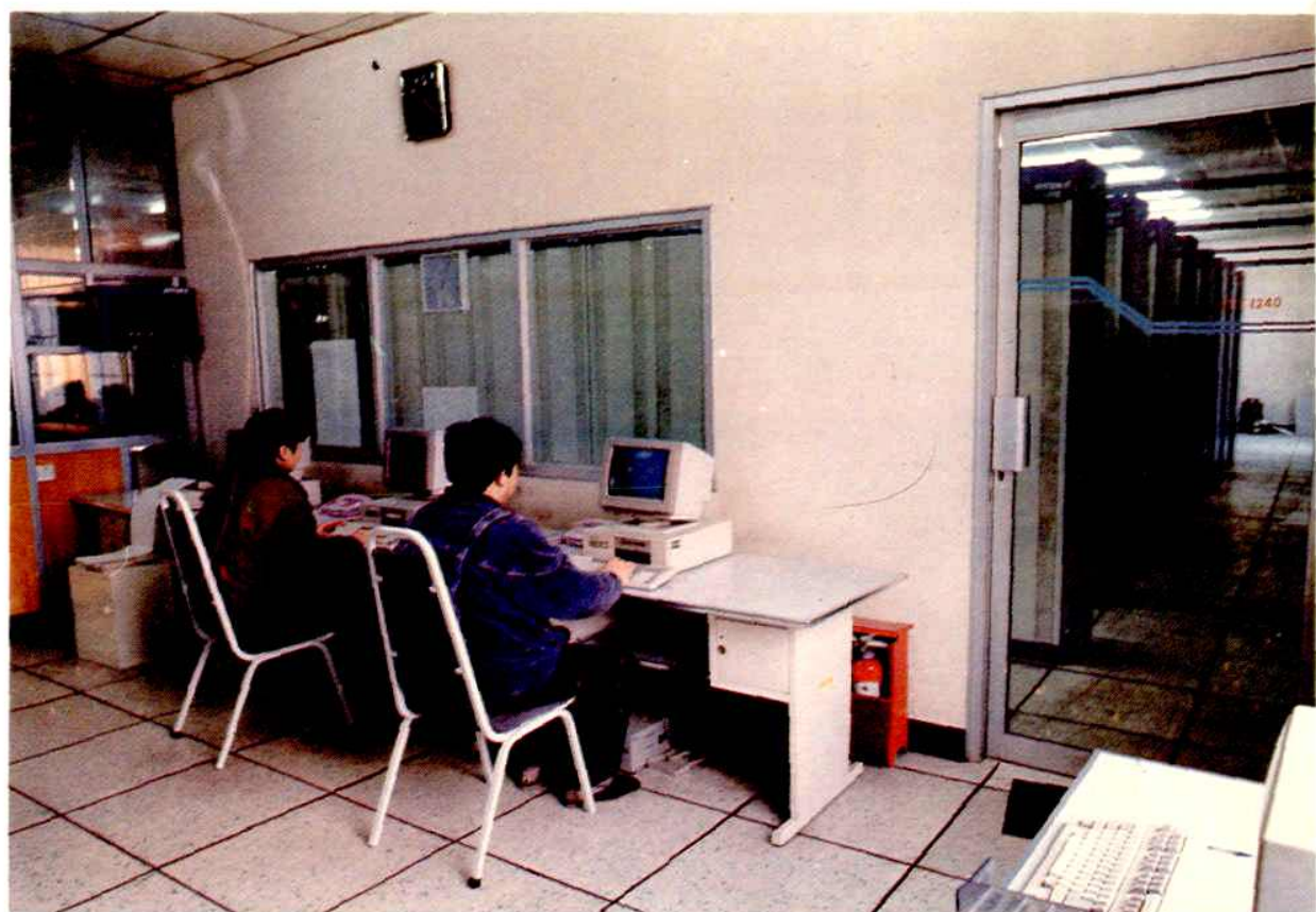
扬州市邮电局 程控交换机房
