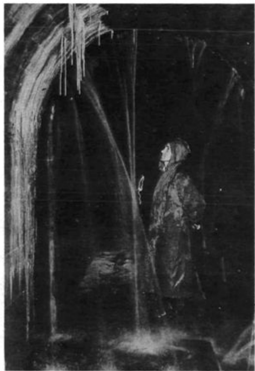
解放初期大坝严重漏水
