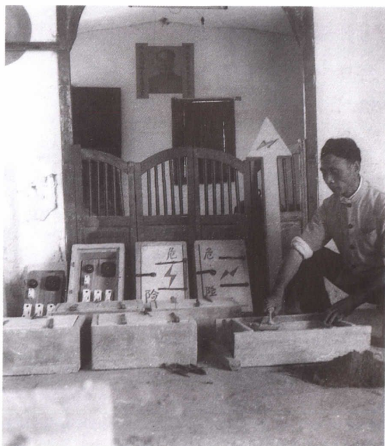
70年代，村电工调试架设在田间的接线箱
