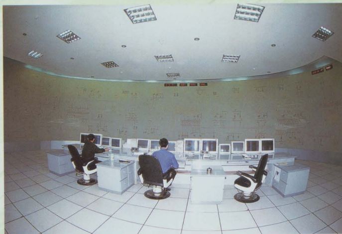
平顶山市电业局调度室
