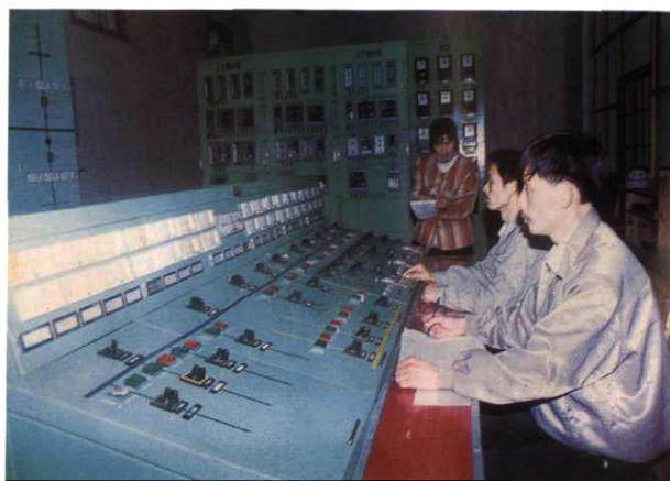
茅山岗电站水电控制室
