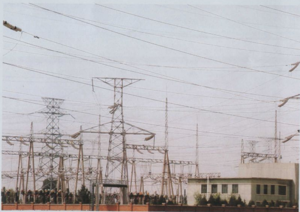
通辽发电总厂 220 千伏开关场
