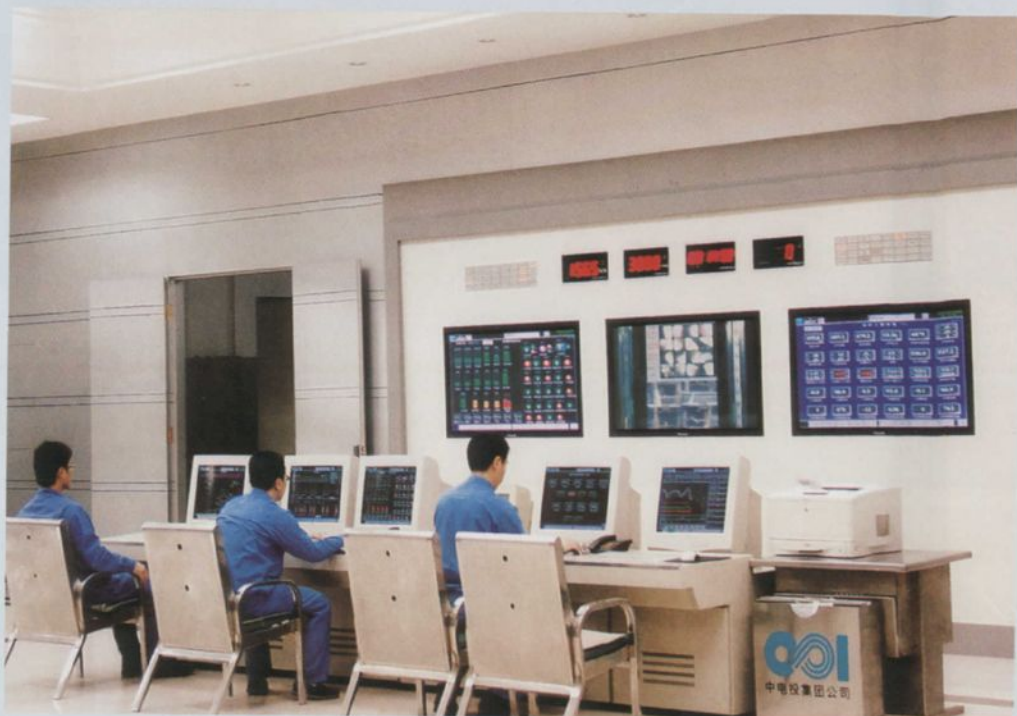
通辽发电总厂单元控制室
