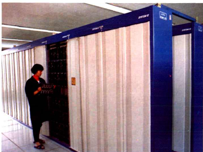
程控电话机房
