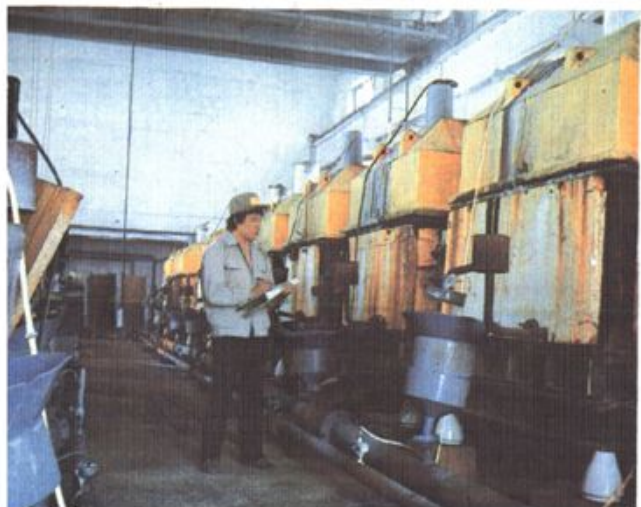
树脂厂电解车间一角
