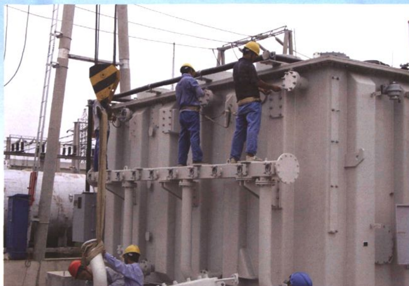
2003年，职工在变电所检修变压器
