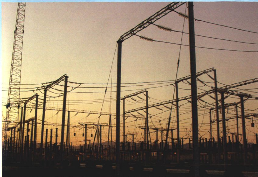
220千伏滁县变电所外景
