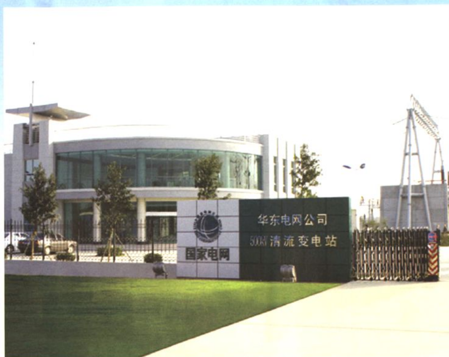
500千伏 清流变电站
