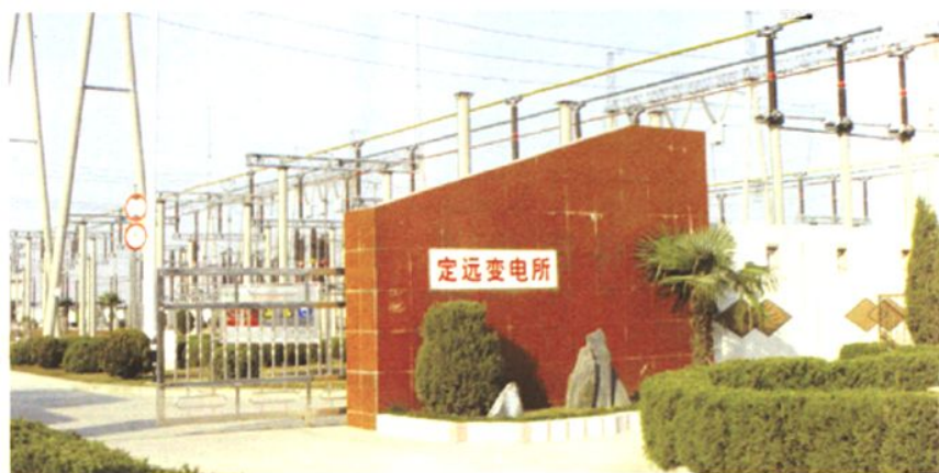
220千伏定远 变电所
