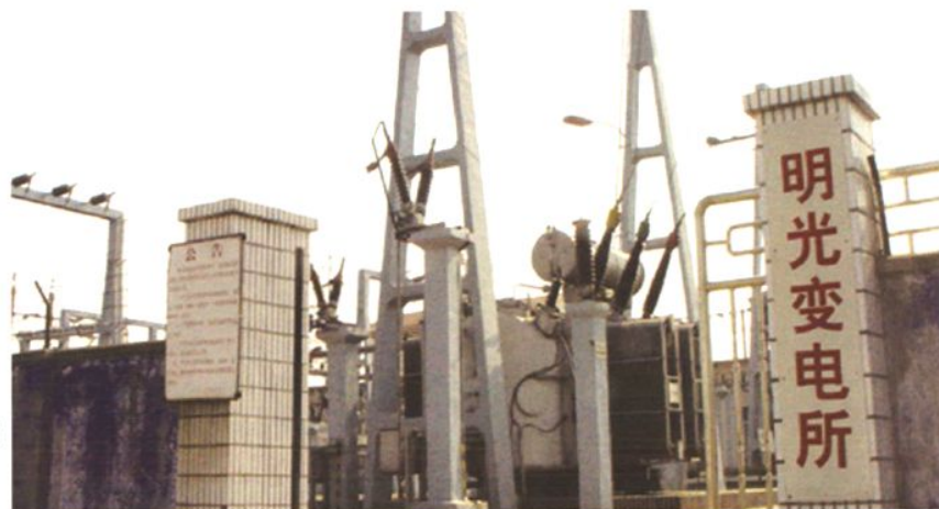
110千伏明光 变电所
