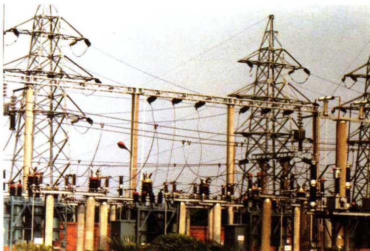
110千伏左庄变电所外景
