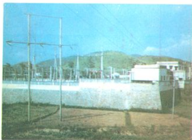
△桂荔 110 千伏龙口变电站
