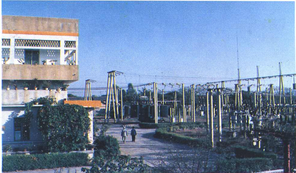
南津 110 千伏变电站
