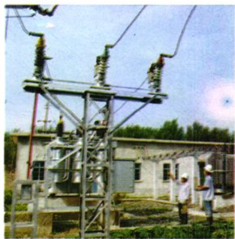
铜井矿区变电站
