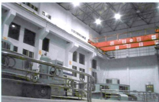
狮子关电站厂房
