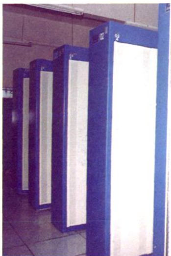
► 右图为程控电话机房。
