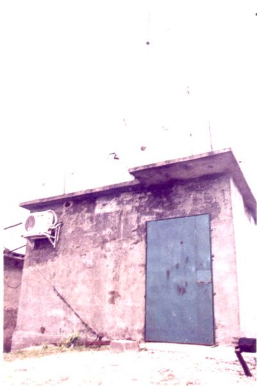
◀ 左图为建于西山圣山岭德圣峰的无线接入基站。
