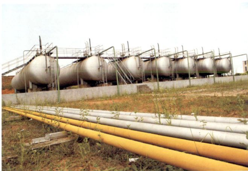
运行公司液化石油气库
