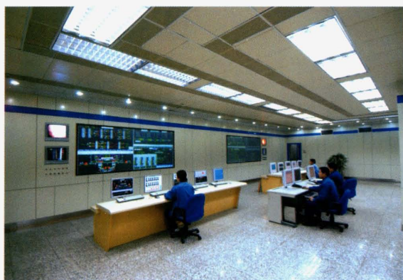
↑ 335MW 机组集中控制室
