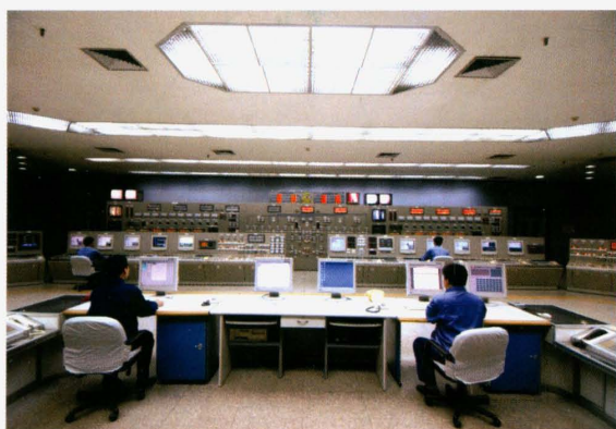
↑ 600MW 机组集中控制室
