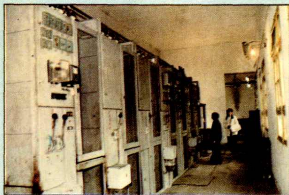
▽火烧滩电站配电房
