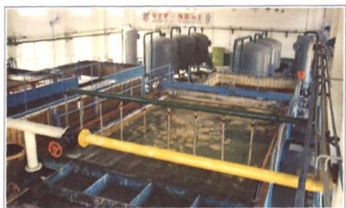
污水处理站内景
