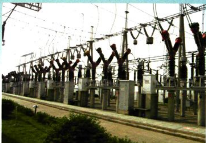
220千伏刘尧变电所一角
