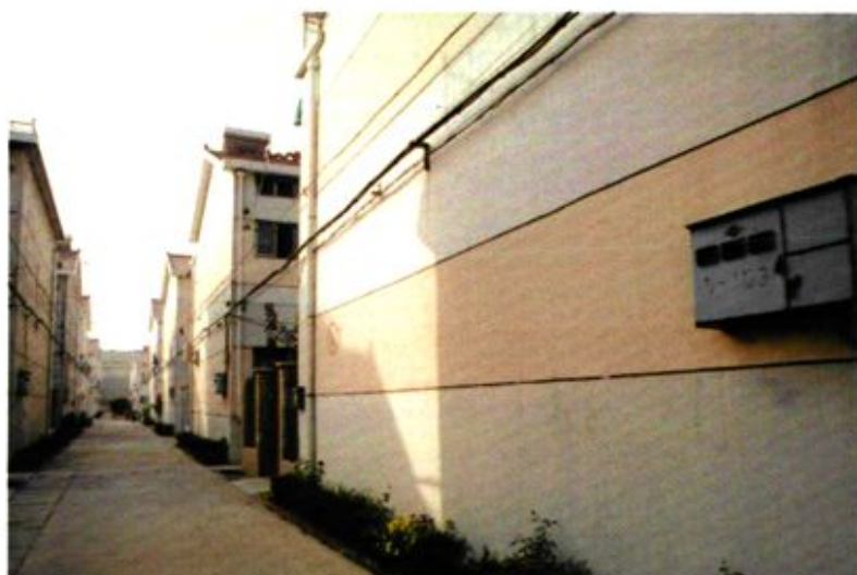
改造后的小区配电
