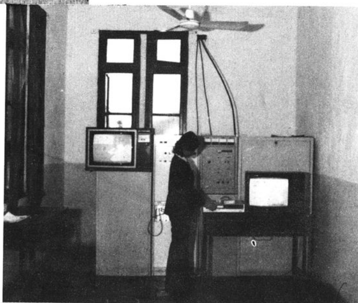
县电视转播台机房
