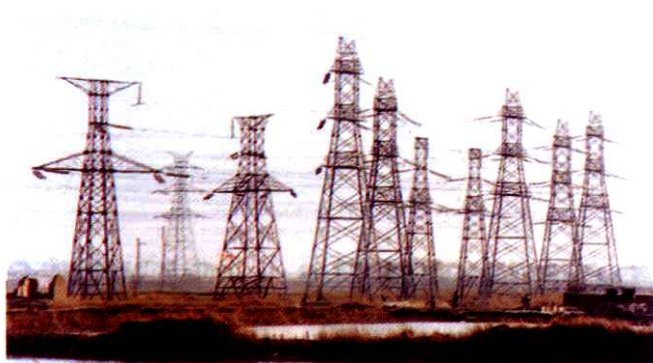
华北电网吴庄子变电站
