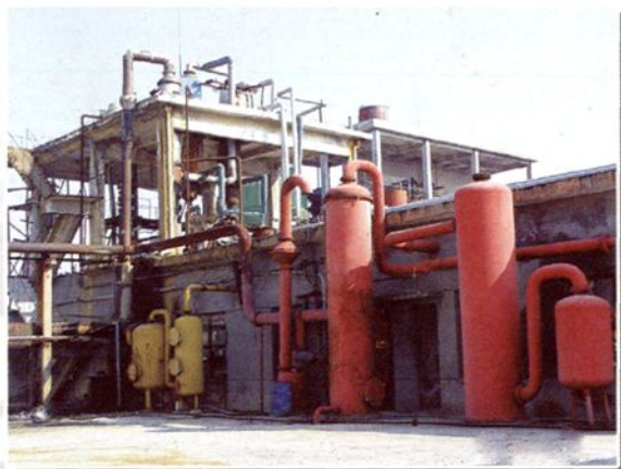
▲ 氯碱酸分厂氯氢处理装置
