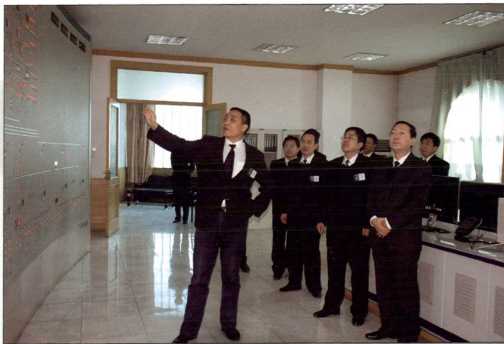
2009年12月4日，运城供电分公司经理刘显哲（右一）在平陆供电支公司调研
