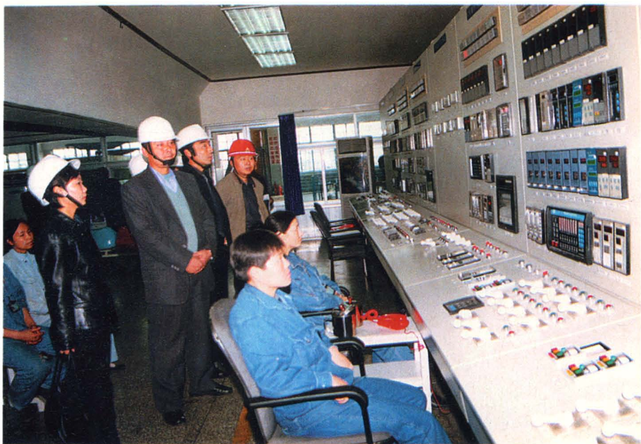
伊犁第一火电厂主控室。
