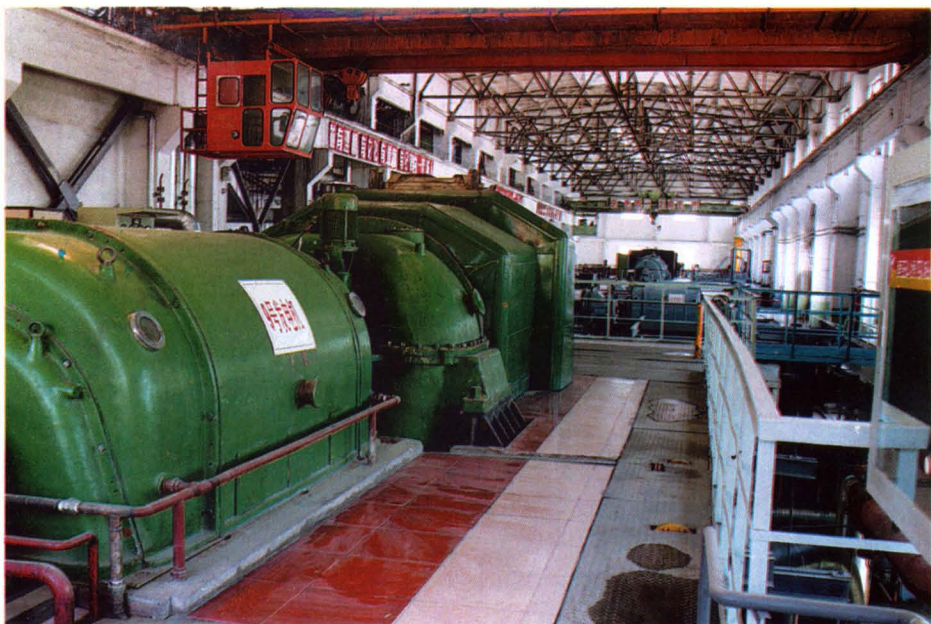
伊犁第一火电厂热网一期工程9号发电机组生产车间全景。
