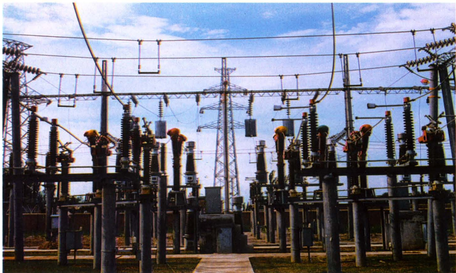
伊宁市西郊变电所。
