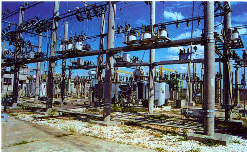
北屯 110 千伏中心变电所局部。
