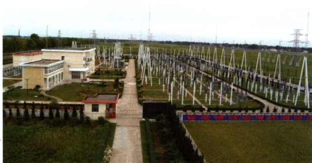
220 千伏高湖变电所
