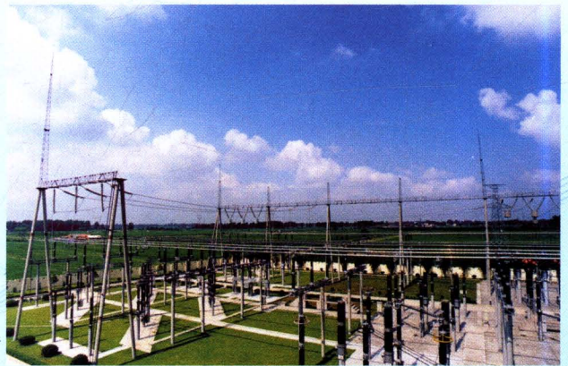
宿州 220 千伏姬村变电所
