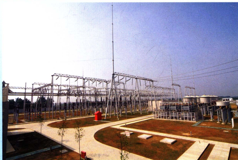
国家优质工程银奖 ——500千伏敬亭变电所
