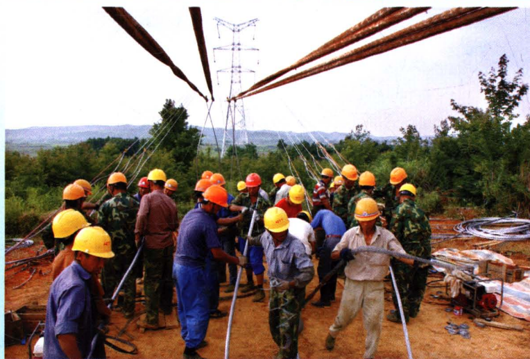
500 千伏宣富线工程
