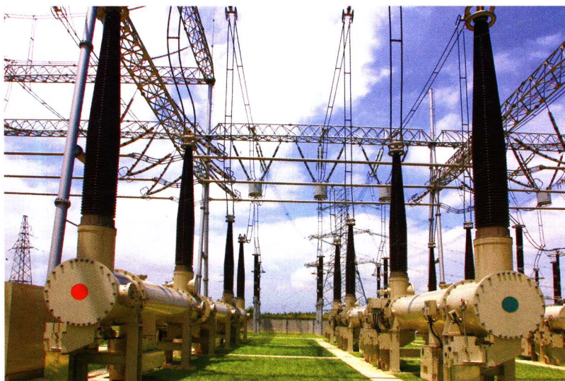
国网公司第一个 500 千伏H-GIS变电所——宣 城变电所
