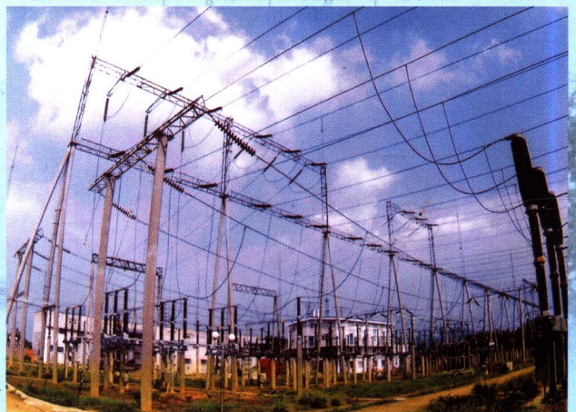
铜陵 220 千伏朱村变电所
