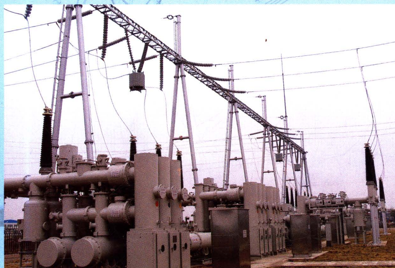
安徽省首座 GIS 变电 所——芜湖220千伏鸠江 变电所
