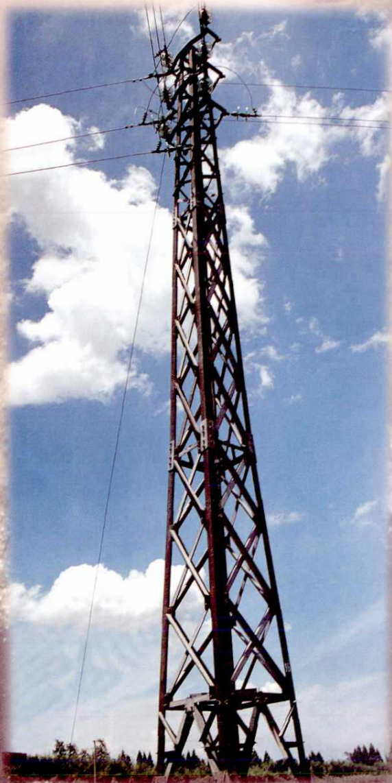
10 千伏配电线路
