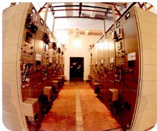
110 千伏白水变电所 35 千伏开关室
