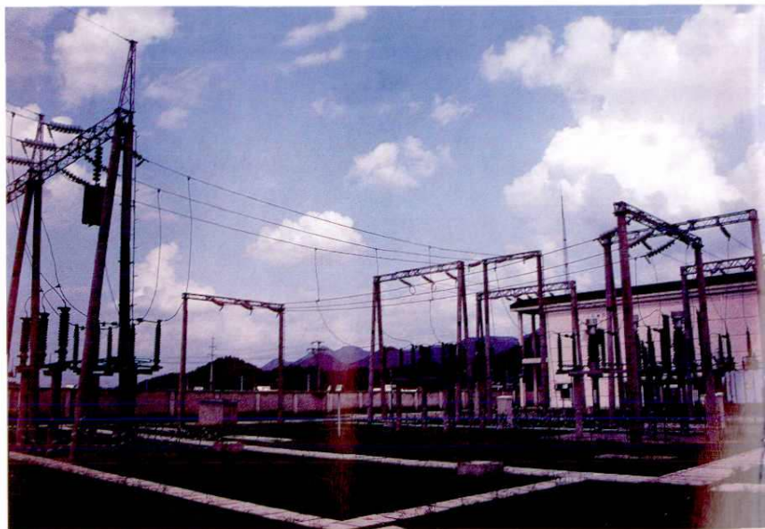
110 千伏白水变电所室外布局
