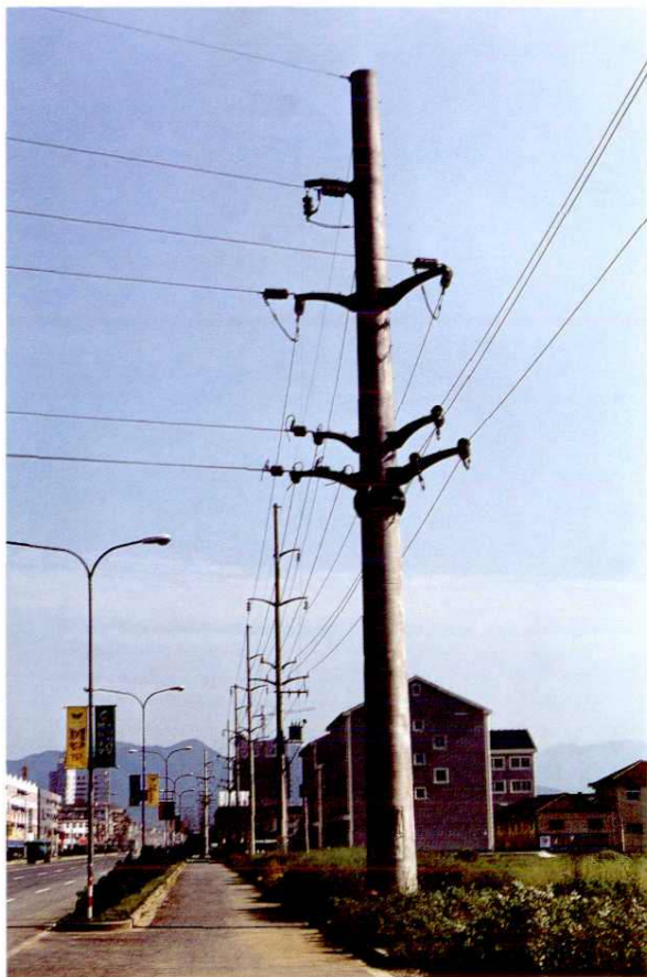
35 千伏递铜线钢管塔
