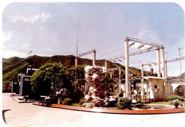
花园式 35 千伏老石坎变电所
