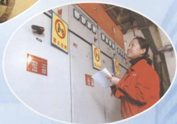
新疆广汇红十月小区 集中供热自动化控制室
