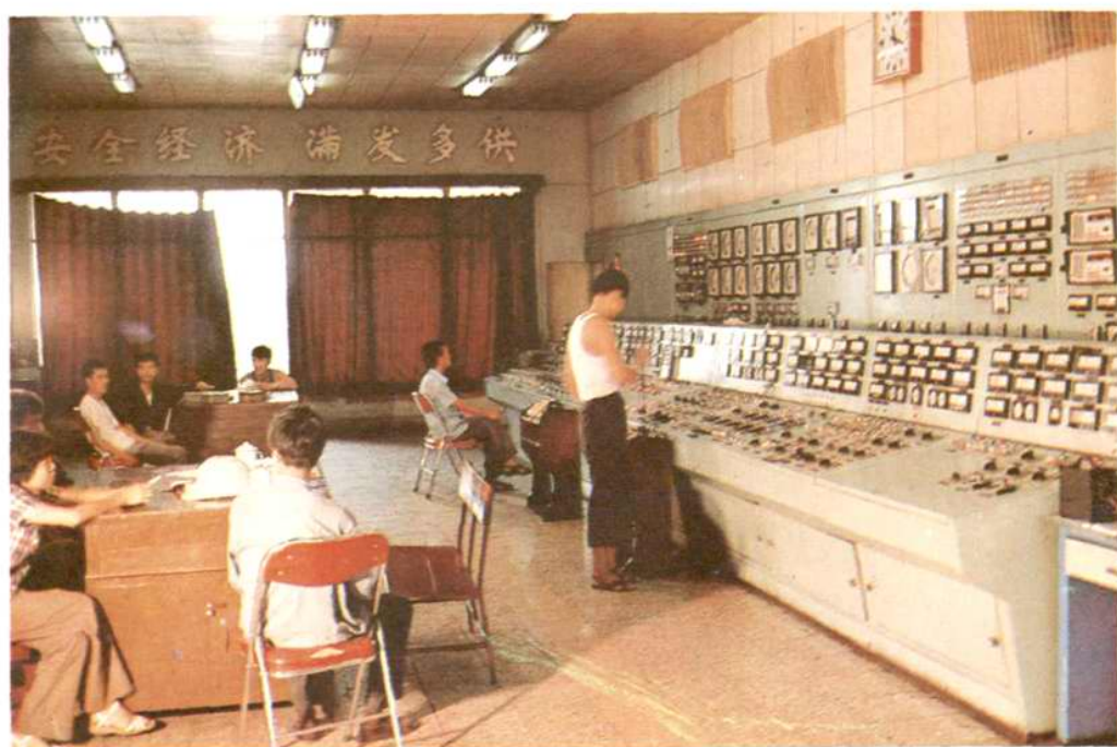
11 # 机炉主控制室
