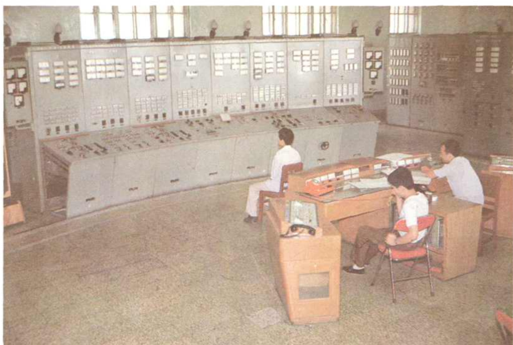
电气主控制室
