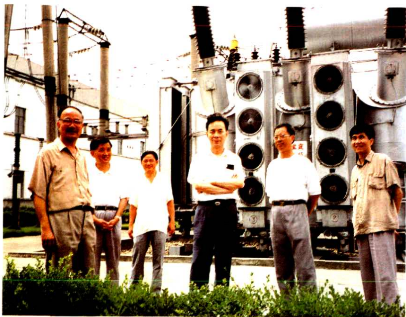
华东电业管理局局长钱忠伟(右三)在苏州金山变电站(1994)
