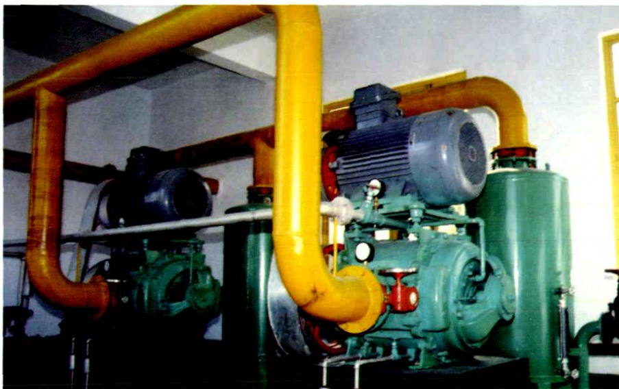
义城煤矿瓦斯抽放系统
