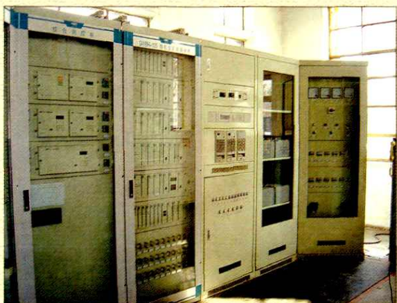
35千伏古县变电站综合自动化控制中心
