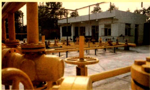
天然气配气站
