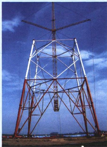
三(峡)广(州)500 千伏 输电线路跨越长江(北岸)钢 管塔之雄姿(塔高 175 米,总 重 400 余吨)(左上)。采用悬 浮抱杆,正在组塔之情形(右 下)(2002)
