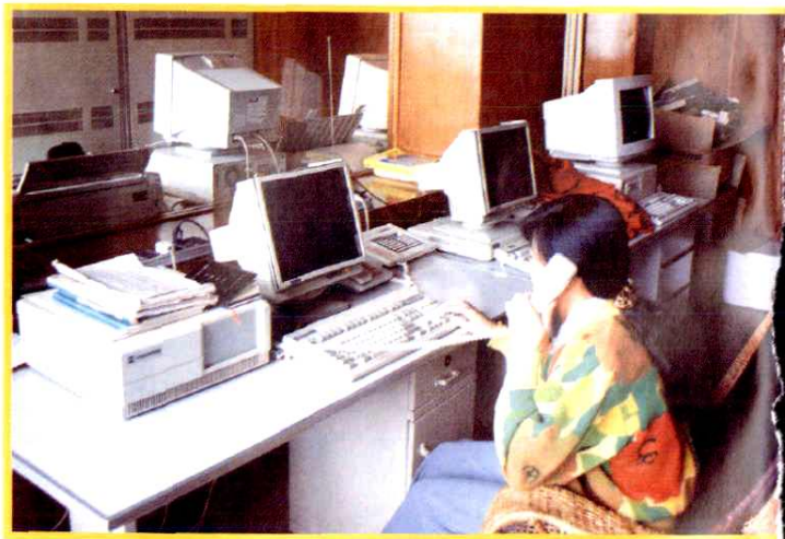
浙江省电力工业局中心调度所程控通信机房
