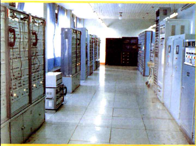
浙江省电力工业局中心调度所 载波通信机房
