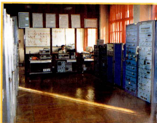
嘉兴电力局调度所载波通信机房
