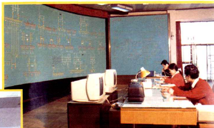
湖州电力局调度室
