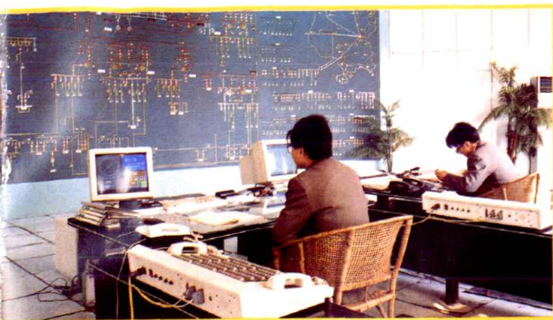
台州电业局调度室
