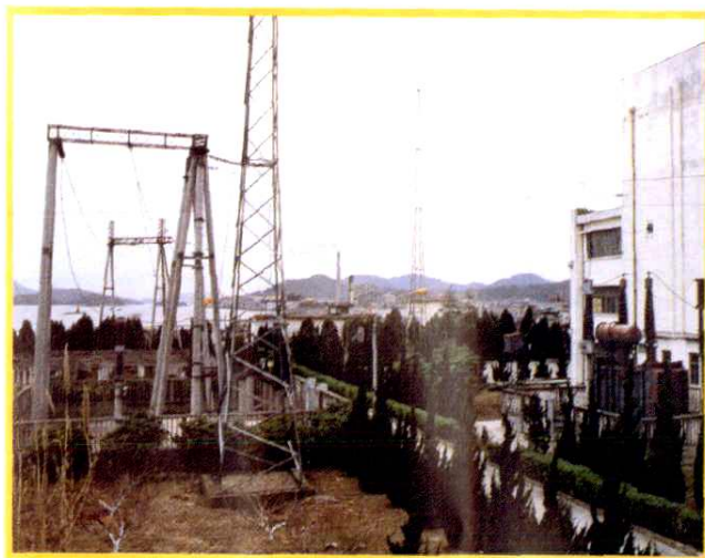
100 千伏直流输电舟山逆变站
