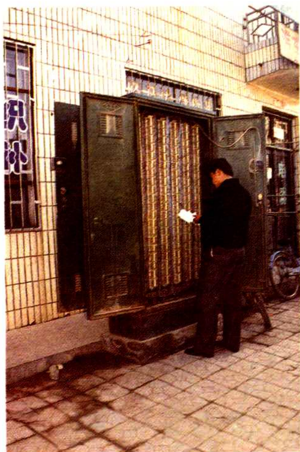
线务员正在检查分线箱
