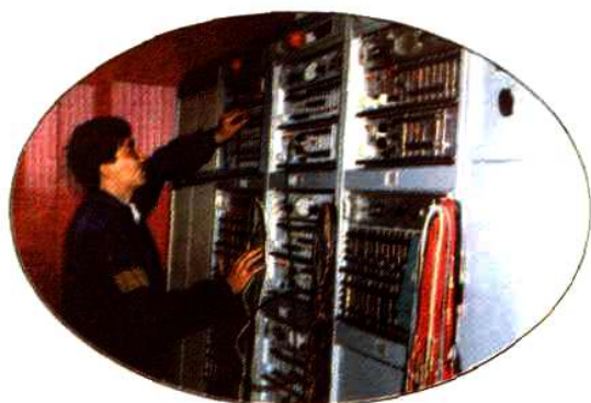
1993年8月22日电报机务员正在割接载波电报电路
