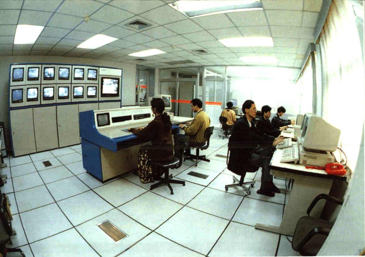
广州邮政通信枢纽总控制室。
