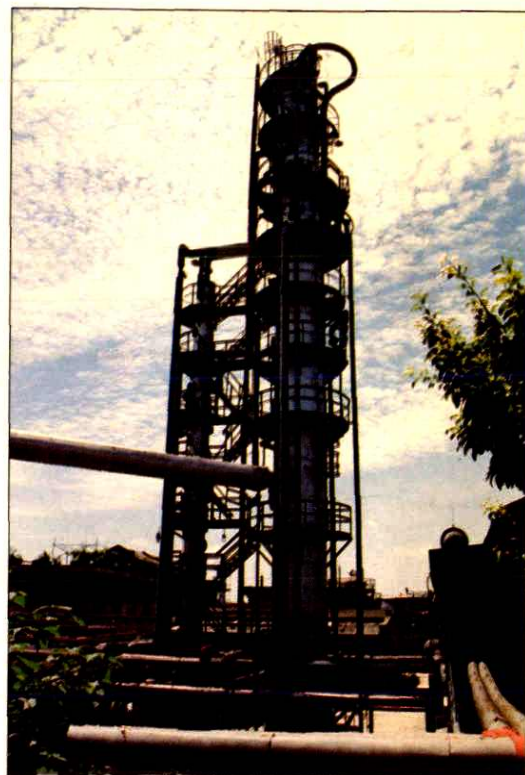
▲ 减压蒸馏装置
