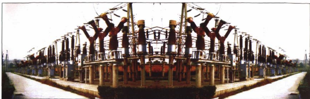
220千伏闻喜变电站
