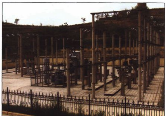
35千伏柏林变电站
