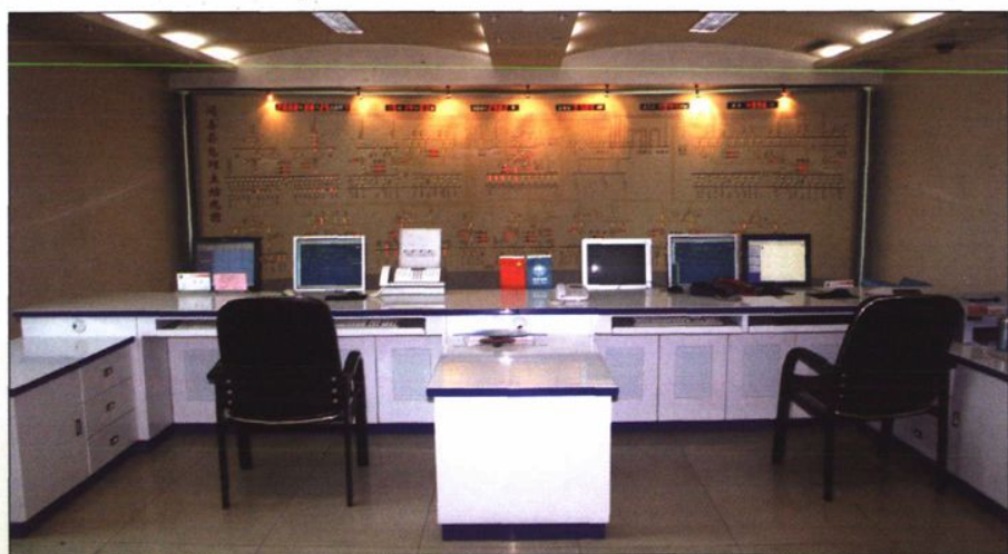
2007年8月，闻喜县电业局调度值班室
