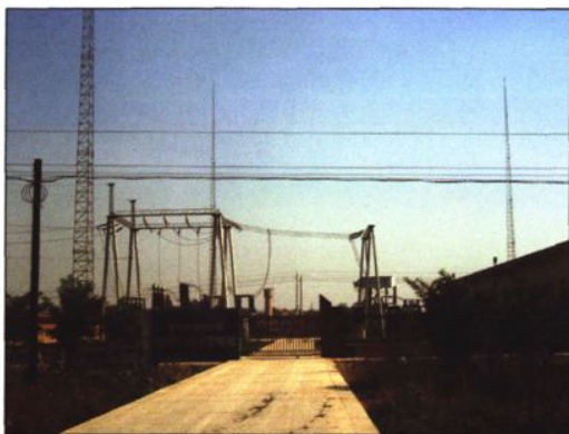
110千伏姚村变电站
