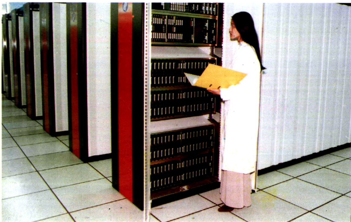
▲现代化的程控通信机房。
