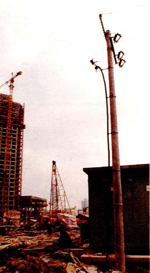
浦东新区施工中的临时用电设施
