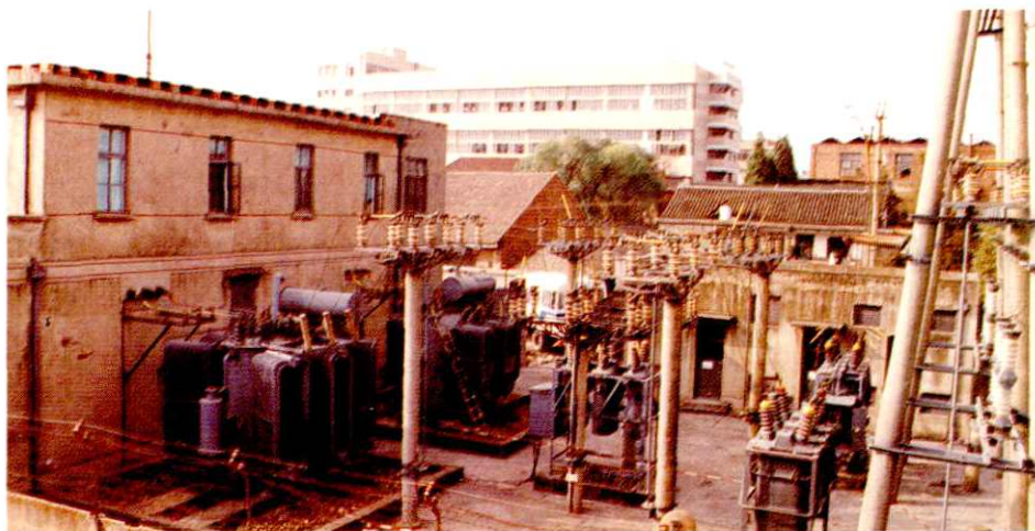
35 千伏杨思变电站（建于 1978 年 2 月）
