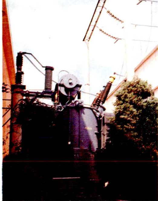
金桥站 110/35 千伏 6.3 万千伏·安 1 号 主变压器
