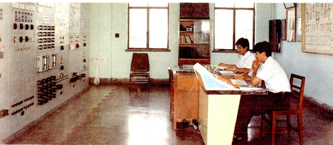
110 千伏金桥变电站控制室
