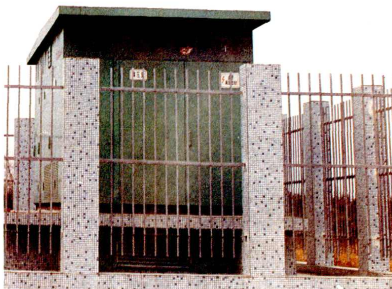
路灯箱式配电站
