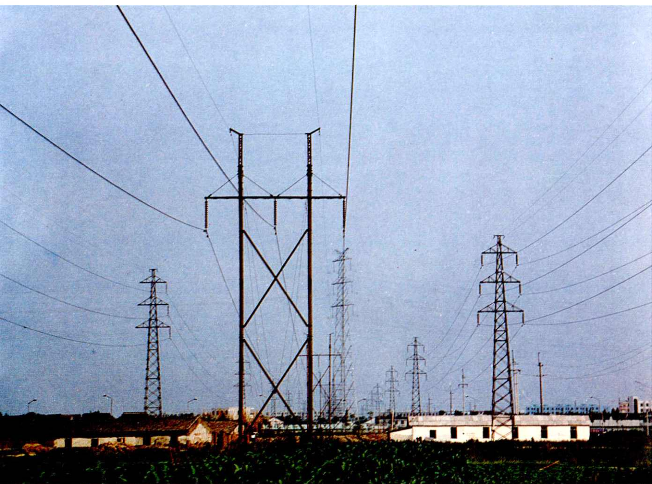
110 千伏高浦 1116、1138 联络线
