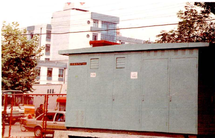
工房箱式配电站
