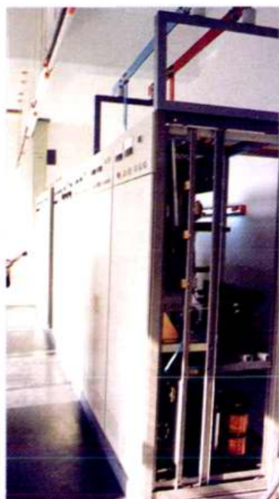
电力室一角(1991 年 摄)
